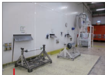
Broyage des bobines extrudées non conformes. Alimentation depuis l'extérieur du local.
