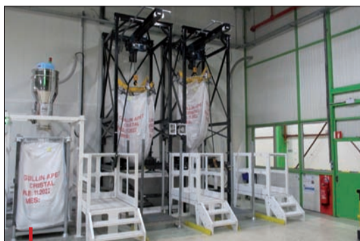
Station double vide big-bags (récupération des squelettes broyés de thermoformeuses). Envoi vers les lignes d'extrusion et mise en silos de l'excédent pour le week-end.
